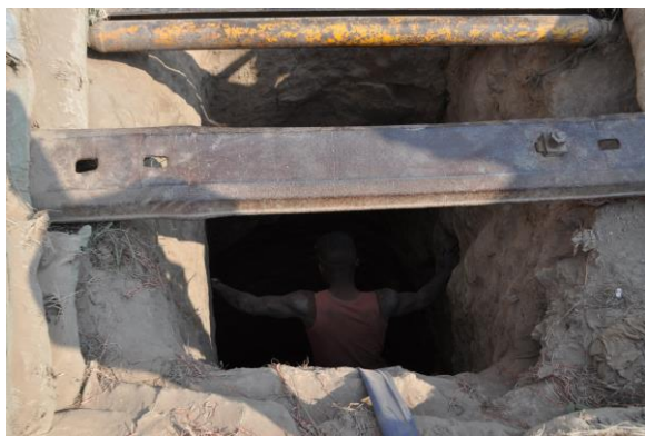
Picture 2 Creuseur without PPE
